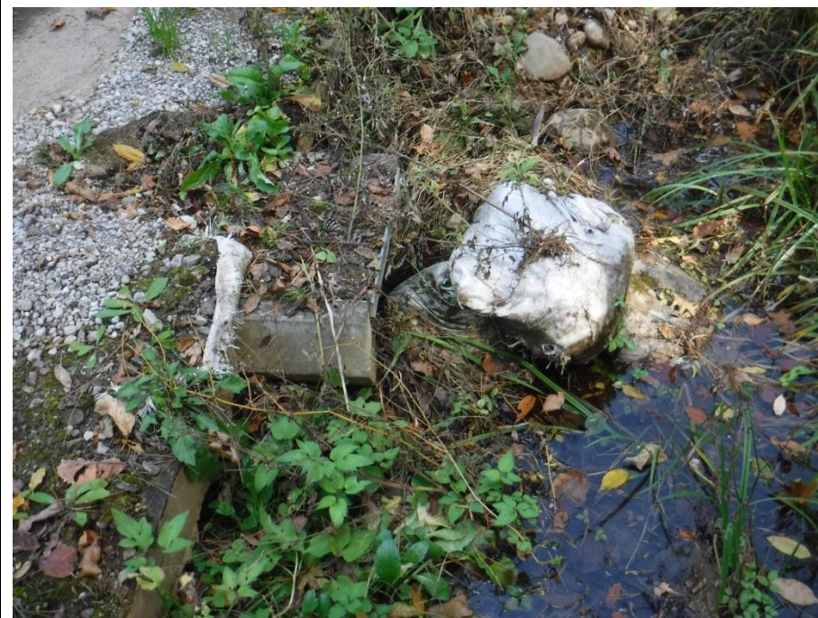
移動した土嚢に塞がれた暗渠
