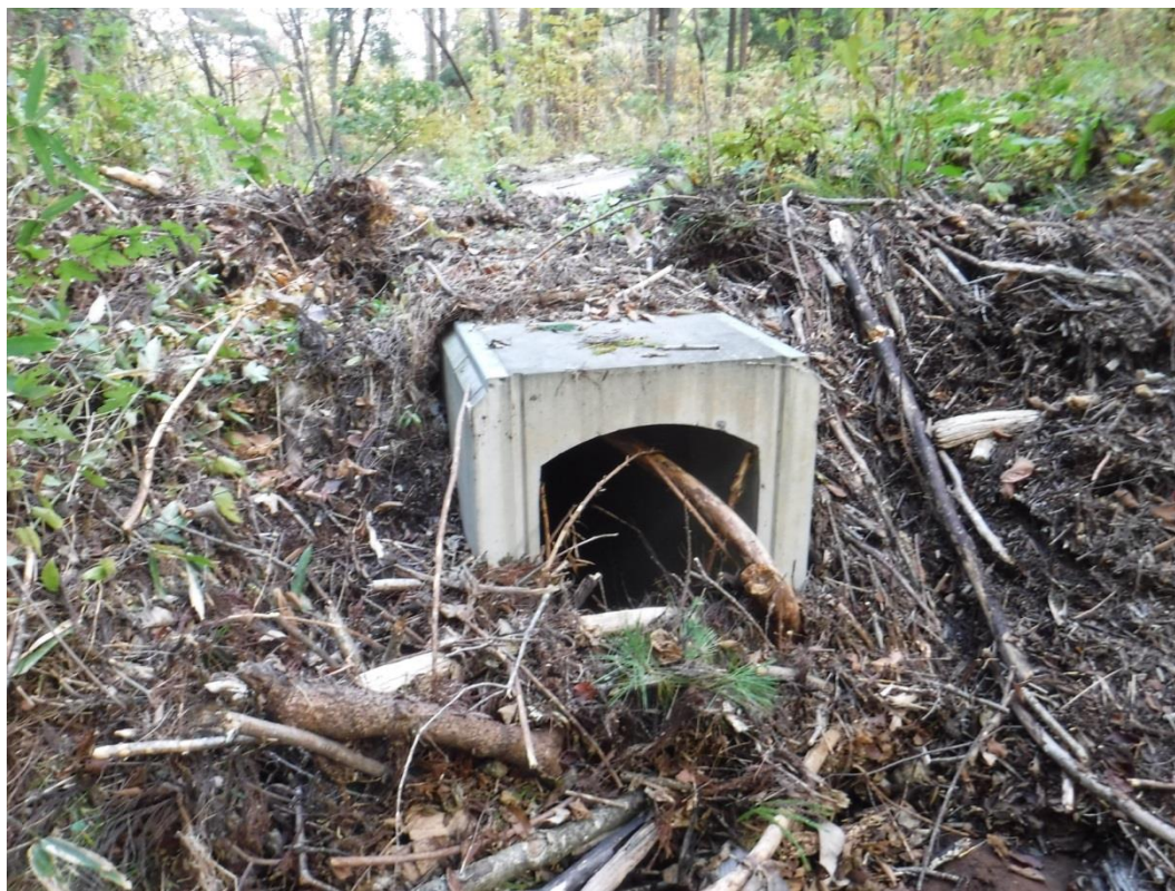
ゴミ（流木）で塞がれた暗渠。道路に流水が溢れ出した。
