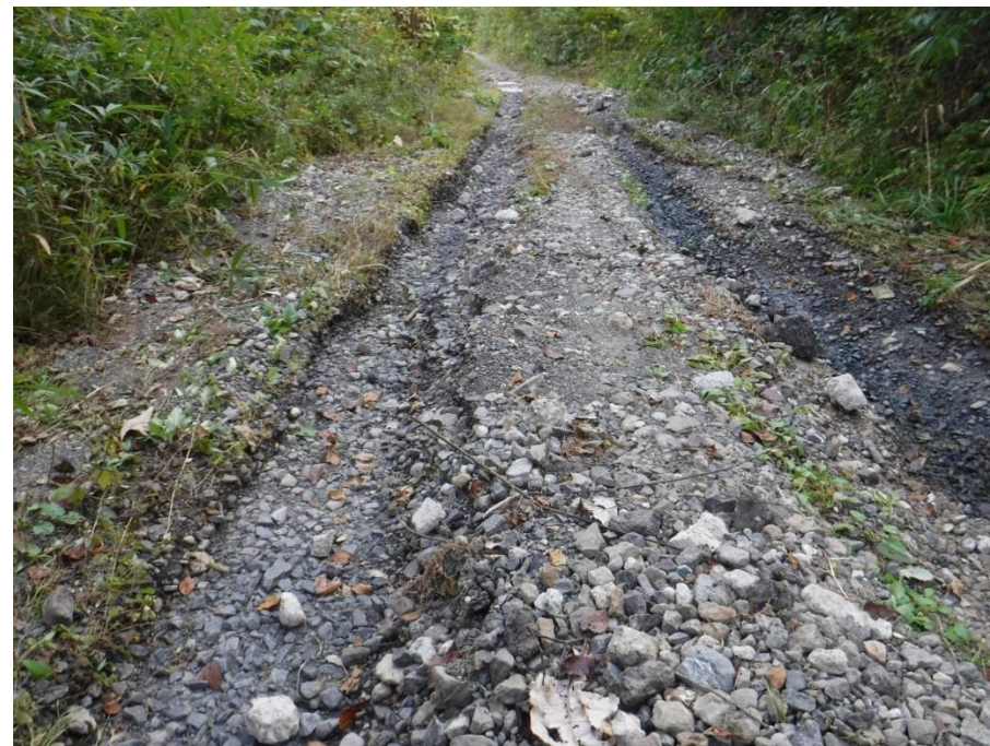
深さ 30 cm にも洗掘された林道。画面左側を通行可能に。
