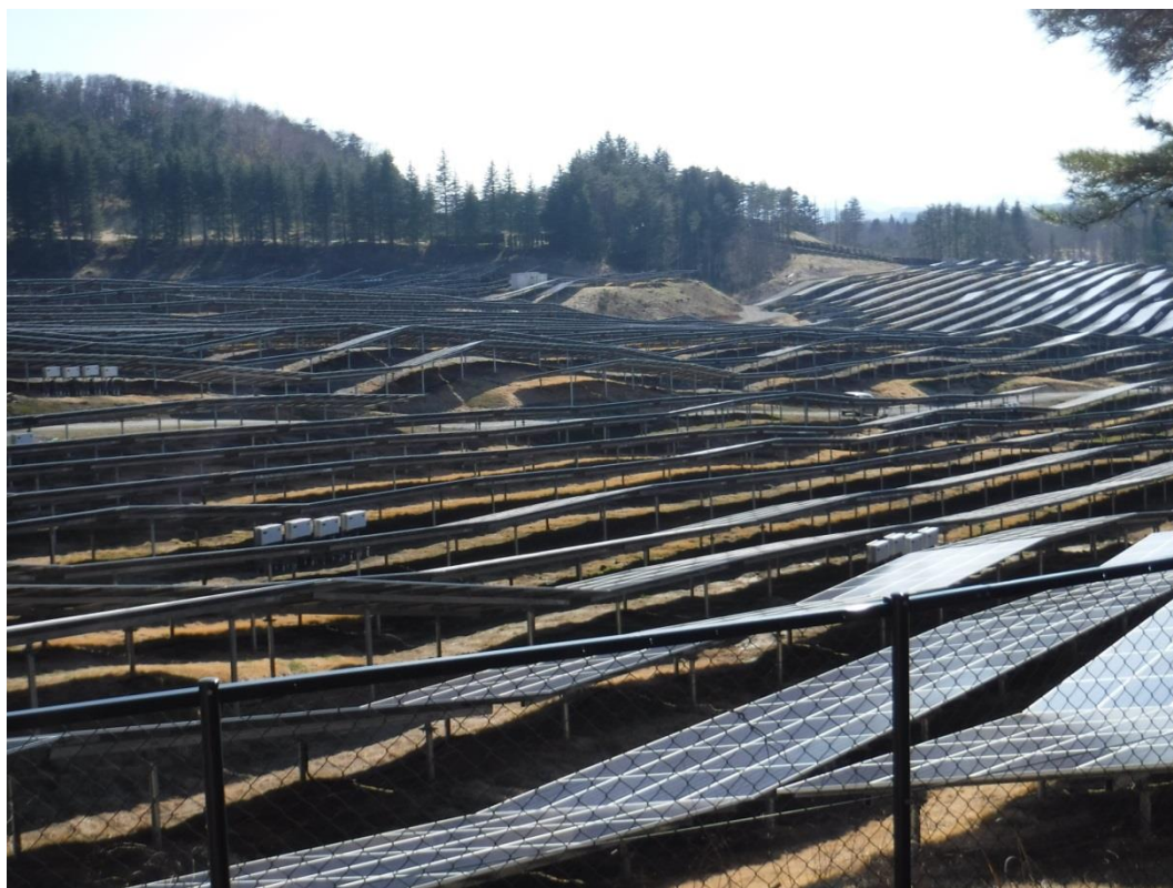
打ち寄せる波の如し太陽光パネル、奥にクラブハウス
