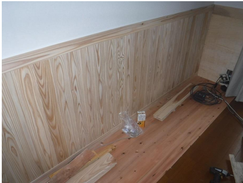
家具の部分の床を張り、腰壁が終了した時点。腰壁の様子がまちまち。
